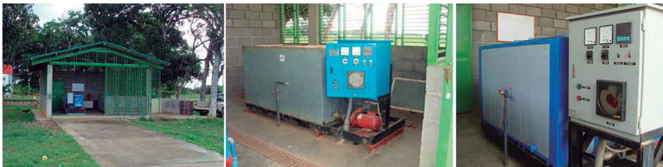
Fotos 1 a, b y c. Cámaras de tratamiento hidrotérmico para semilla asexual de caña de azúcar. Estación Local Yaritagua, INIA Yzacuy.
