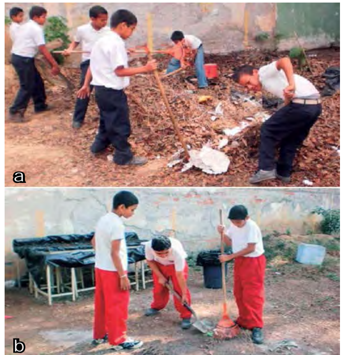
Foto 1 a y b. Jóvenes en las tareas de acondicionamiento del área donde se instalará el huerto escolar.
